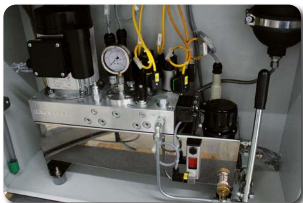
Unidad de alimentación hidráulica
